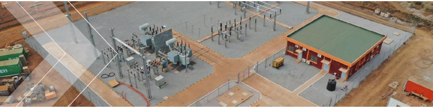
Subestación de alta tensión en el proyecto Séguéla
